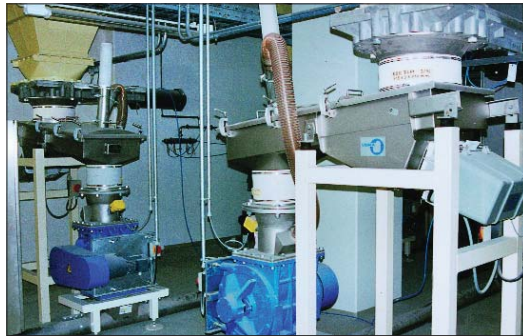
Bild 13: Bunkerabzugrinnen mit elektromagnetischem Antrieb
