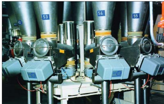
Bild 14: Bunkerabzugrohre mit elektromagnetischem Antrieb
