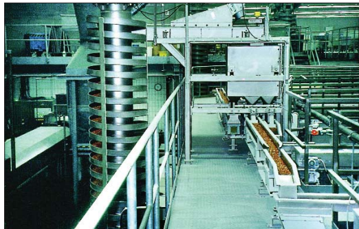
Bild 4: Vibrationswendelförderer und -förderrinnen in einer Nahrungsmittelfabrik
